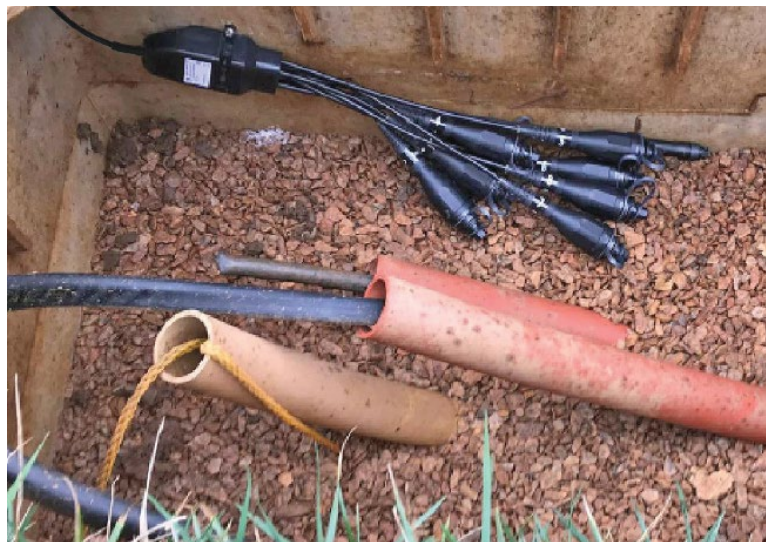
Figura 41 – Ejemplo de despliegue de una caja FST en arqueta
